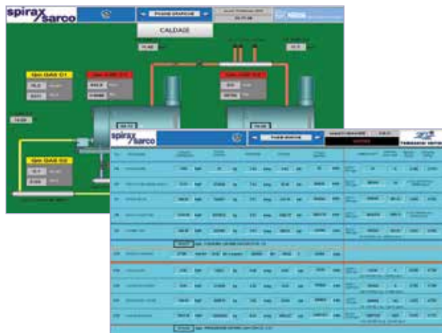
Contabilizzazione centrale termica con calcolo dell'efficienza
